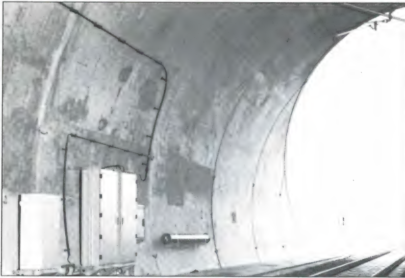
Zo lopen de draden door de tunnel naar de zogenaamde tunnelstations.
